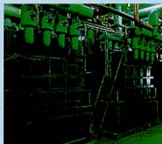
排水処理設備
